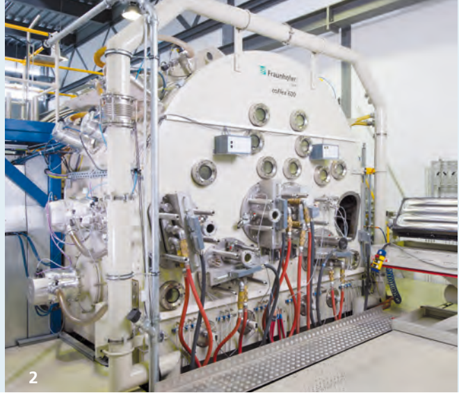
2 Rolle-zu-Rolle Pilotbandbeschichtungsanlage coFlex® 600
